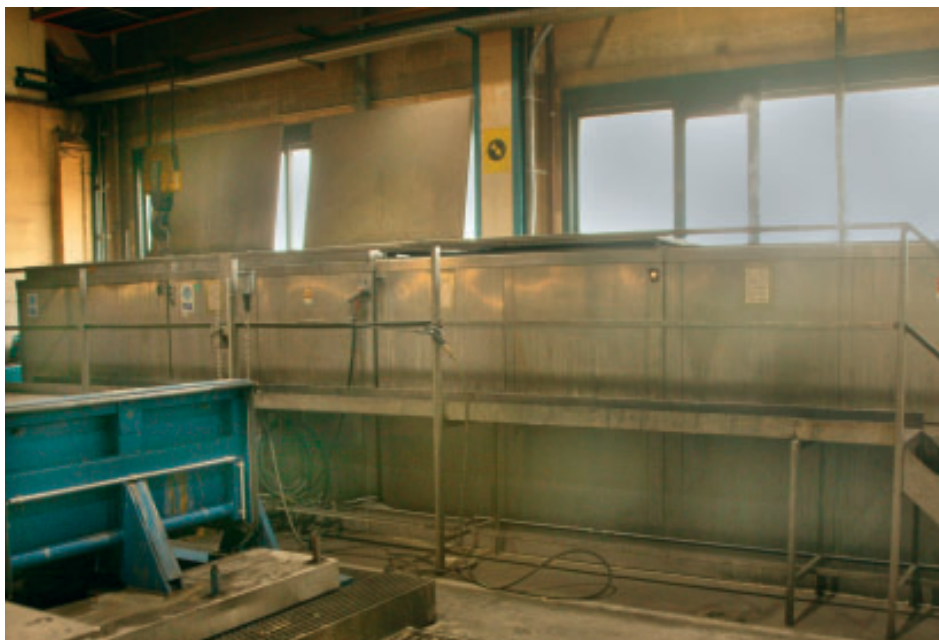
Bade-Anstalt: Die erweiterte FISA-Anlage besteht aus zwei Reinigungsbecken, einem Spülbecken und einem Konservierungsbad (von links)
