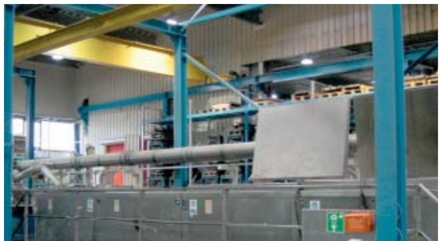
Bild 3: Die erweiterte FISA-Anlage besteht aus zwei Reinigungsbecken, einem Spülbecken und einem Konservierungsbad.
